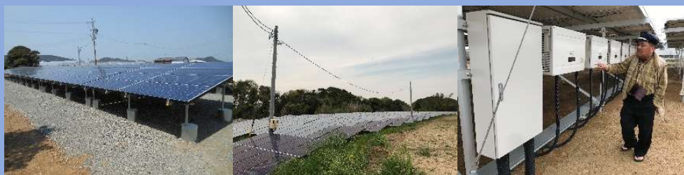
自社太陽光発電所 市内9ヶ所、他3ヶ所 計89万kW/年間
