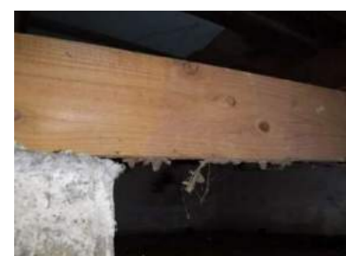
←洗面室の床下 ↓ 多くの蟻道(シロアリの通り道)があり、シロアリの生息も確認できました。
